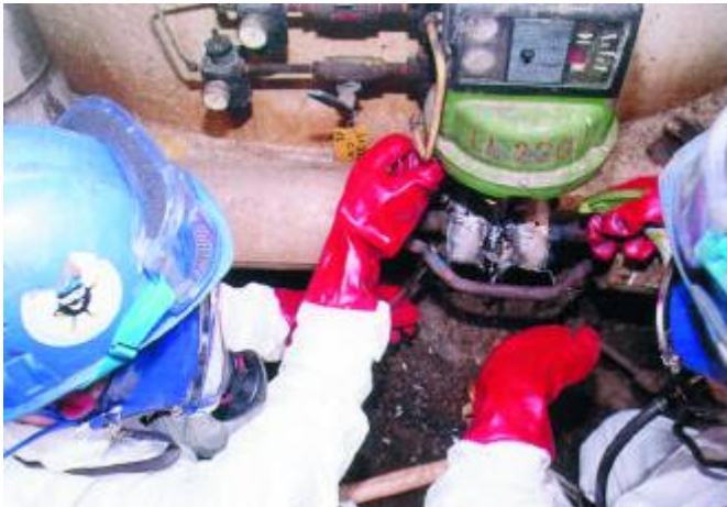
Demontarea în aer liber a unei benzi împletite din azbest pe o electrovănă
